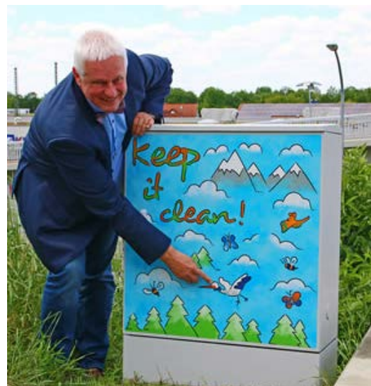
Peter Krämer mit einem Stromverteilerkasten - Motiv Luft
