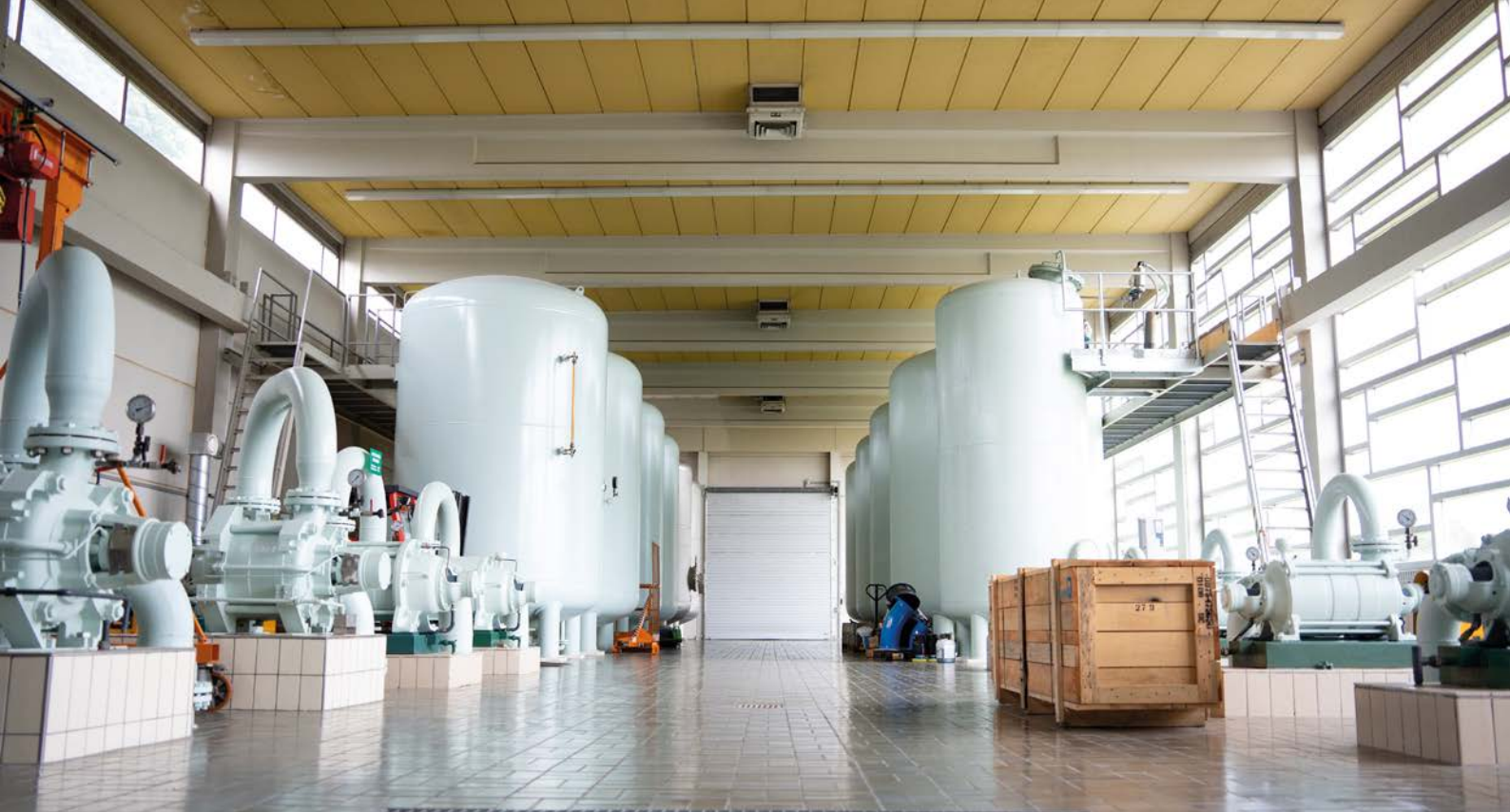
Filterhalle im Wasserwerk Hemsbach
